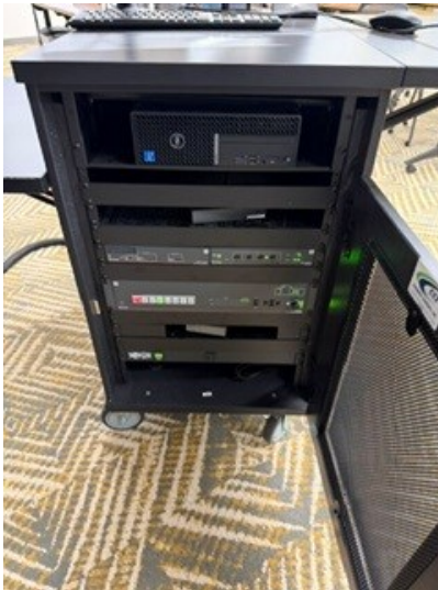
16U of secure rack space for AV equipment
